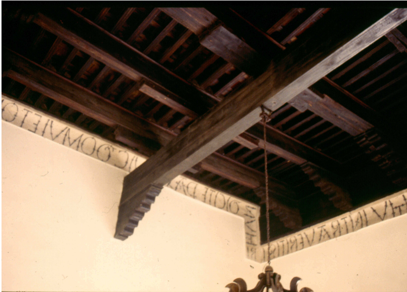
Falsa viga de sujeción en el zaguán de la entrada
